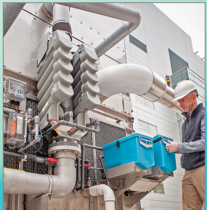
Hệ thống xử lý nước gắn tại nhà máy Smart Shield®
