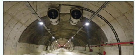
Hệ thống thông gió đường bộ – FRP Lớp nhiệt độ cao
