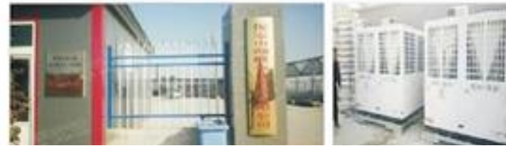
Dự án sưởi ấm nhà kính nông nghiệp Bảo Định
